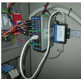
Cable Ethernet del PLC conectado en el switch/PLC Ethernet cable connected to the switch.
